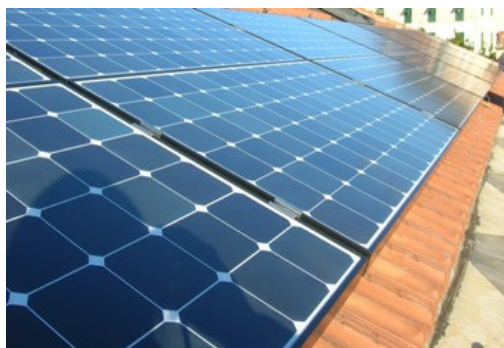
Impianto fotovoltaico a Calice Ligure (SV)
